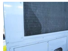
室外機の油にじみ
