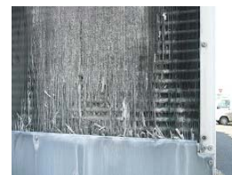
室外機の腐食
